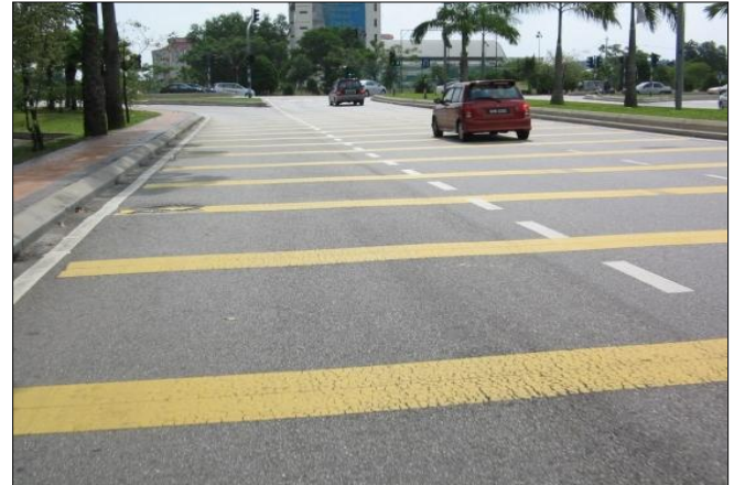
Foto17:Contoh permukaan jalan yang dikasarkan ( corrugated road surface ) di sebelah kawasan rekreasi.
